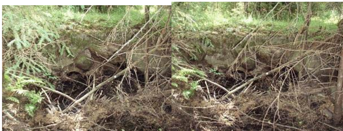
Bild 48 och 49. Vandringshinder vid skogsväg.
