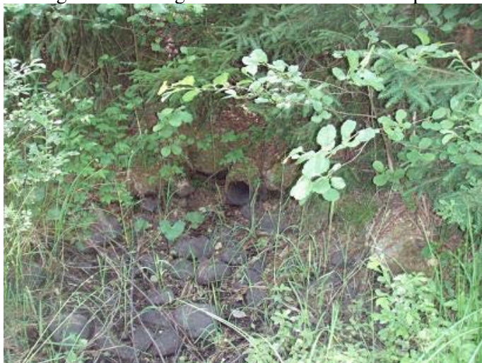
Bild 56. Rör under skogsväg
