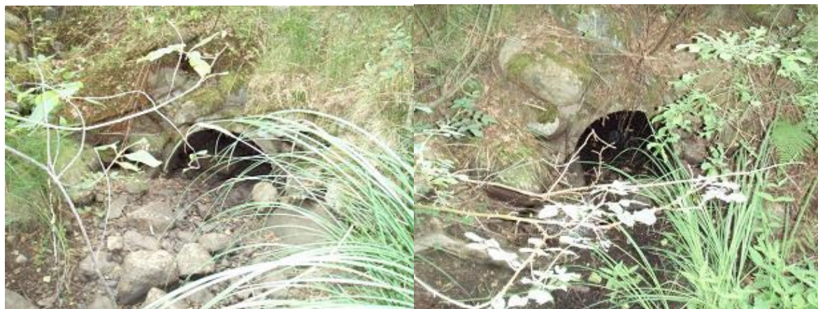
Bild 50 och 51. Vandringshinder vid skogsväg
