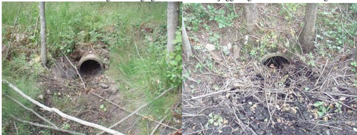
Bild 52 och 53. Vandringshinder vid skogsväg.
